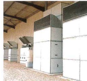
Ventilation répondant aux normes sanitaires et environnementales
