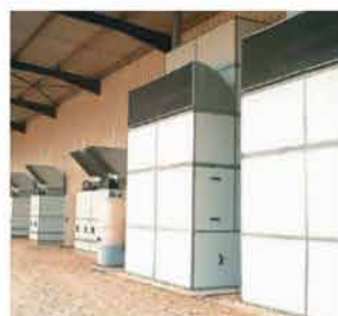
Ventilation répondant aux normes sanitaires et environnementales
